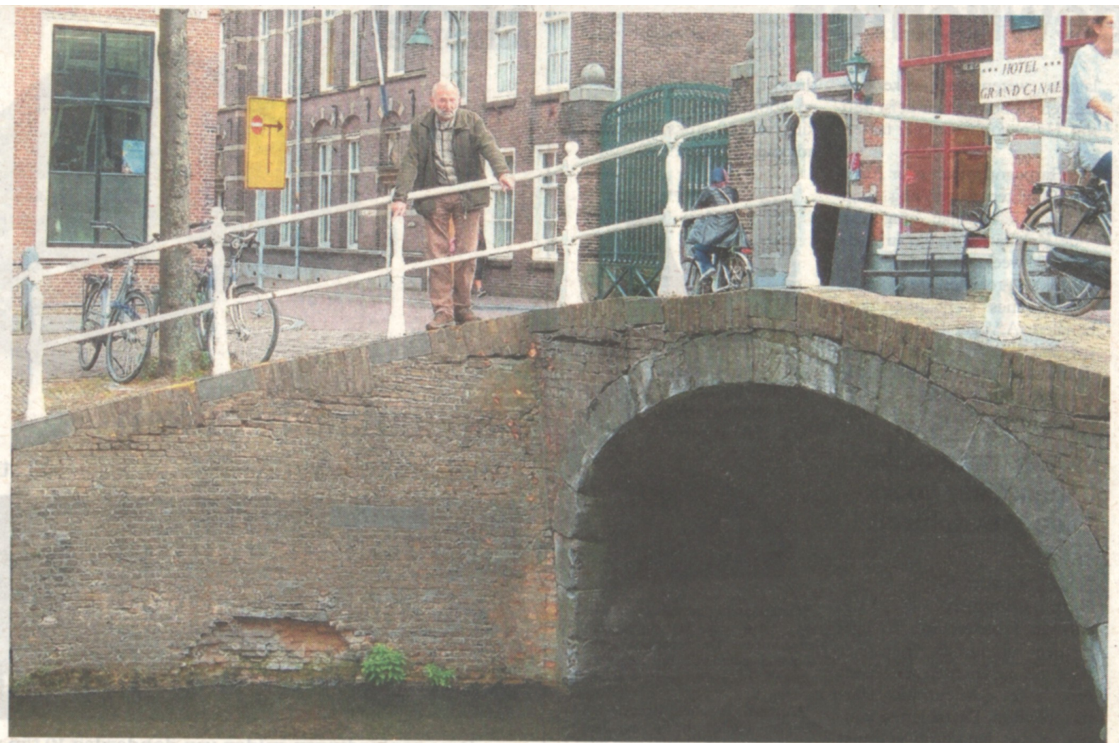
Henk van Bergen wijst naar de zere plek, een scheur in het metselwerk van de Weesbrug. "Dit is toch te gek voor woorden."
